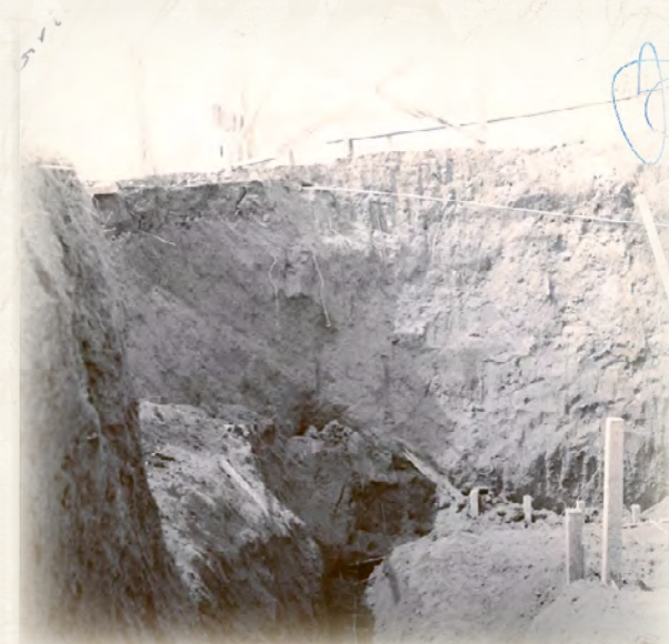
Fotografia parcial do local, mostrando também a parede onde desprende a massa de terra, e o local onde os operários foram soterrados.
